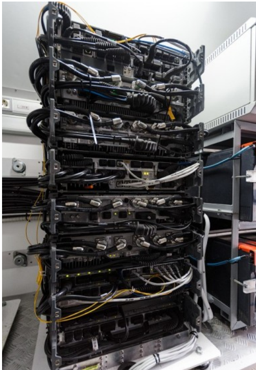
Рисунок 2 - Оборудование мобильной базовой станции BTS Flexi MCPA FHDB DOI: https://doi.org/10.18454/ENGIN.2023.1.3.2
